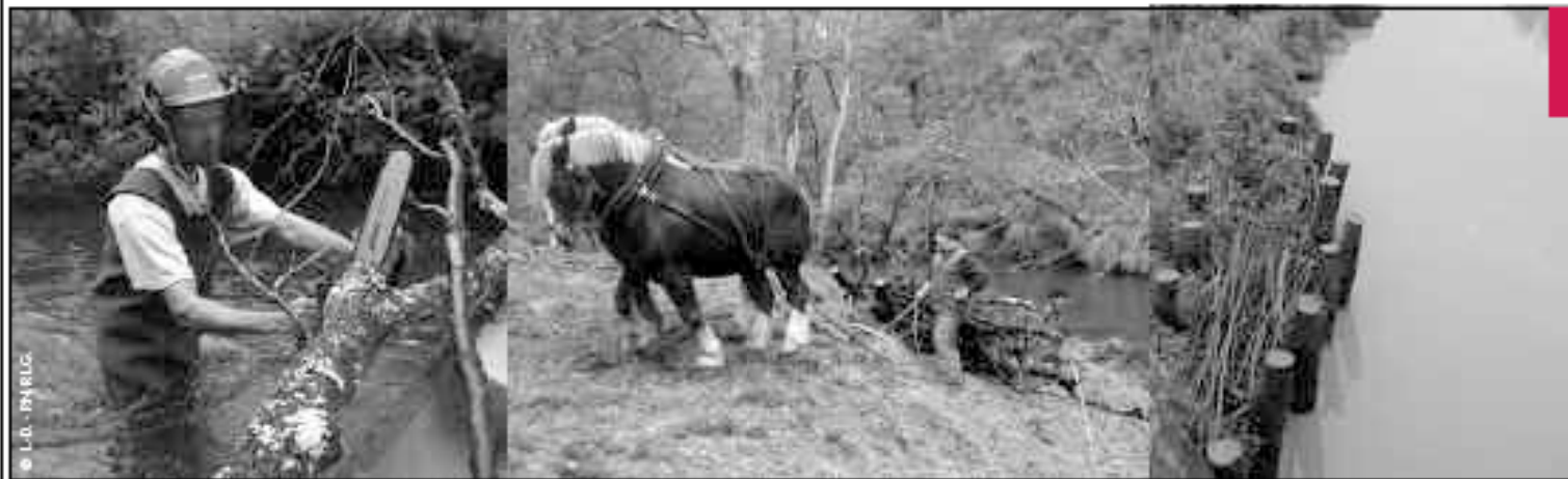
Les types d'interventions sur la rivière : bûcheronnage et débardage à cheval, et au besoin, protection de berges.
